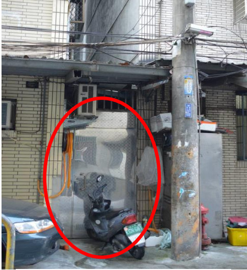
防火巷被搭建圍成私人倉庫
